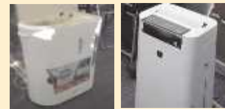
空気清浄機を設置
